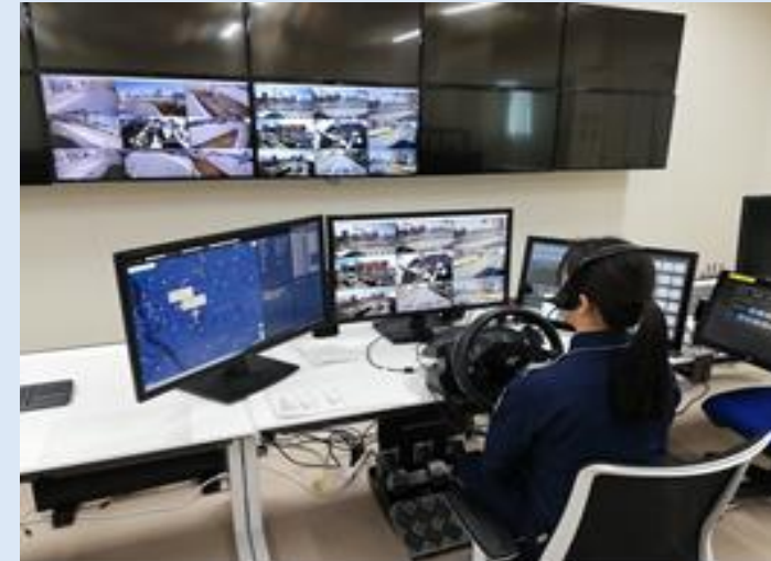
監視センター
