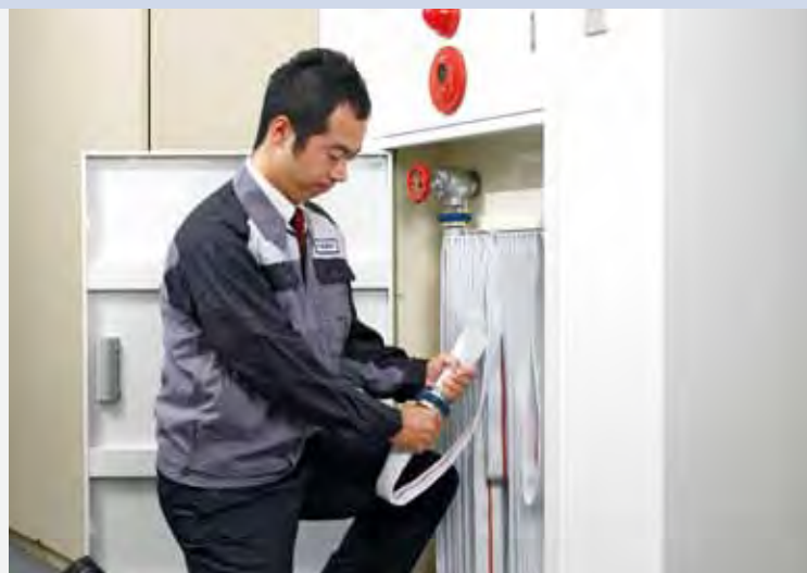
消防設備点検
