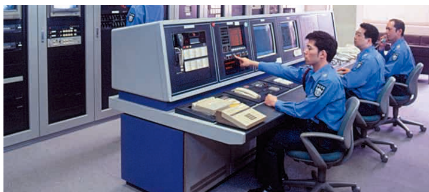
防災センター
